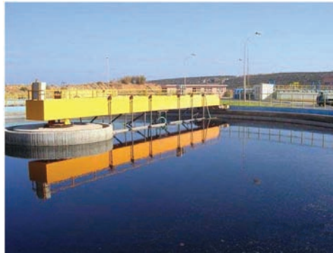
Εικόνα 2. Δεξαμενή Β΄ Καθίζησης της Εγκατάστασης Επεξεργασίας Υγρών Αποβλήτων Χανίων.
